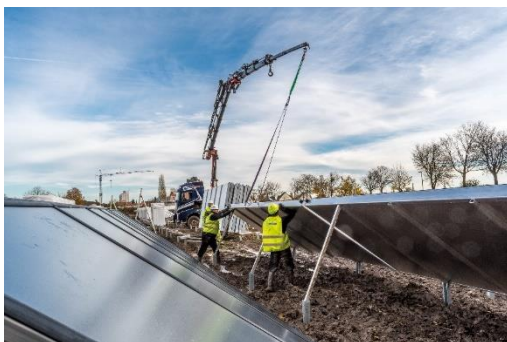
Solarthermische Großanlage in Ludwigsburg/Kornwestheim. Foto: Guido Bröer
